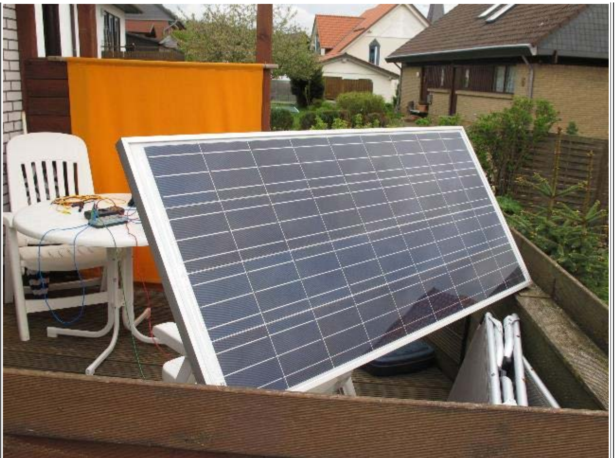
Abb. 05: Um auszuschließen, daß der Stress von den Wechselrichtern kommt, wurde der Kollektor an eine Batterie angeschlossen. (FB)
